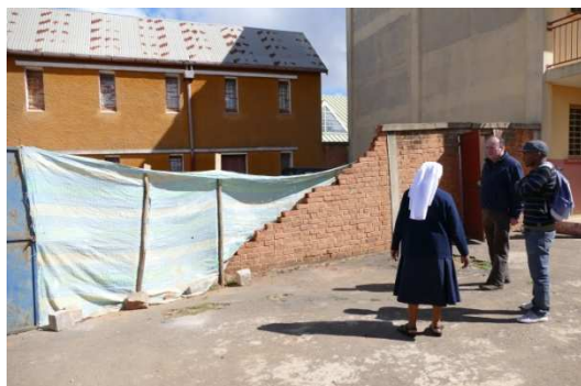
Figure 31 - Mur d'enceinte écroulé suite au cyclone
