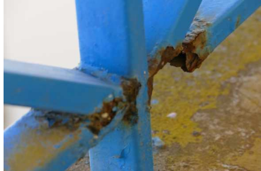
Figure 33- Garde corps rouillé
